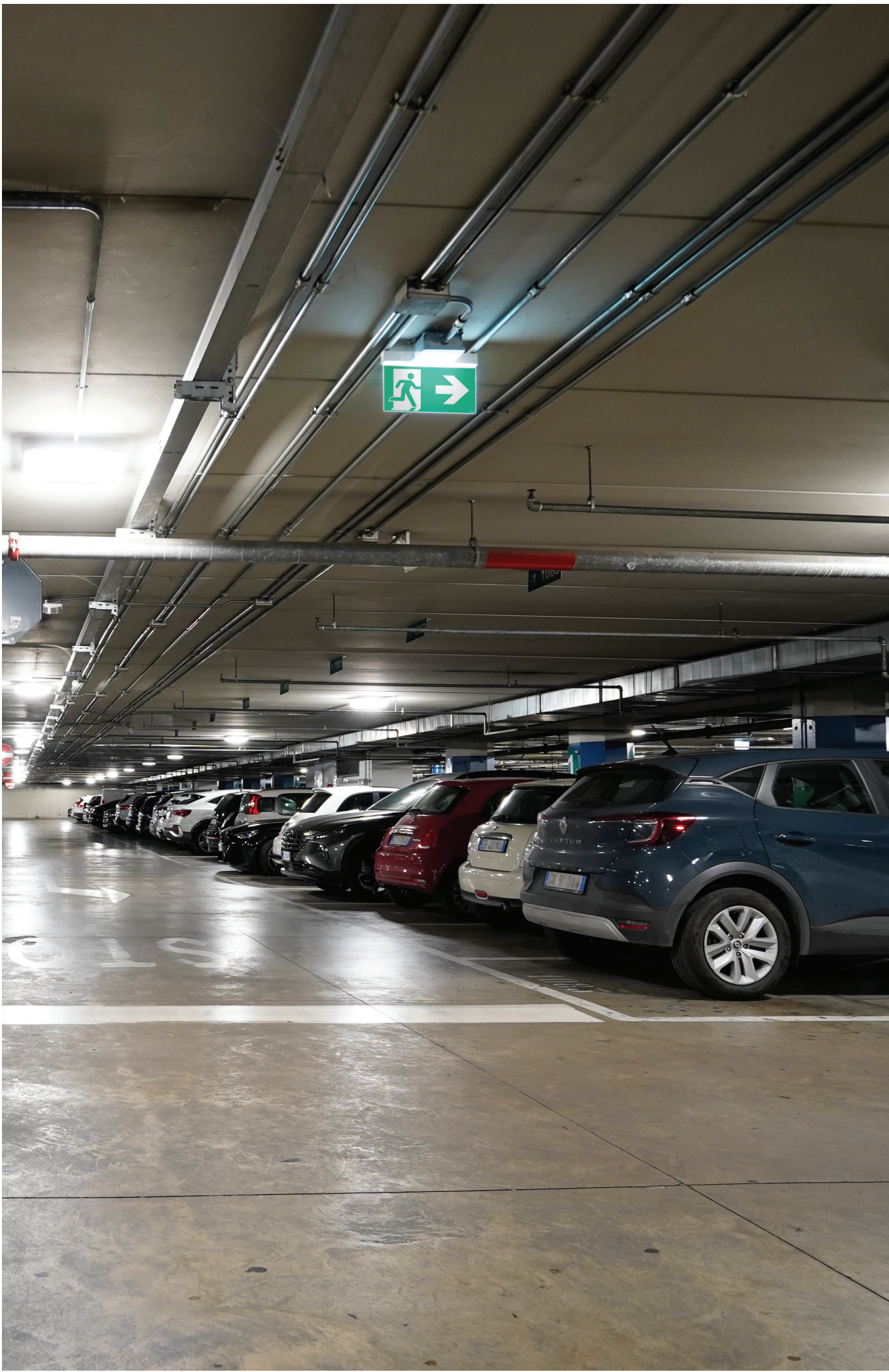
131 segnaletica / exit sign
