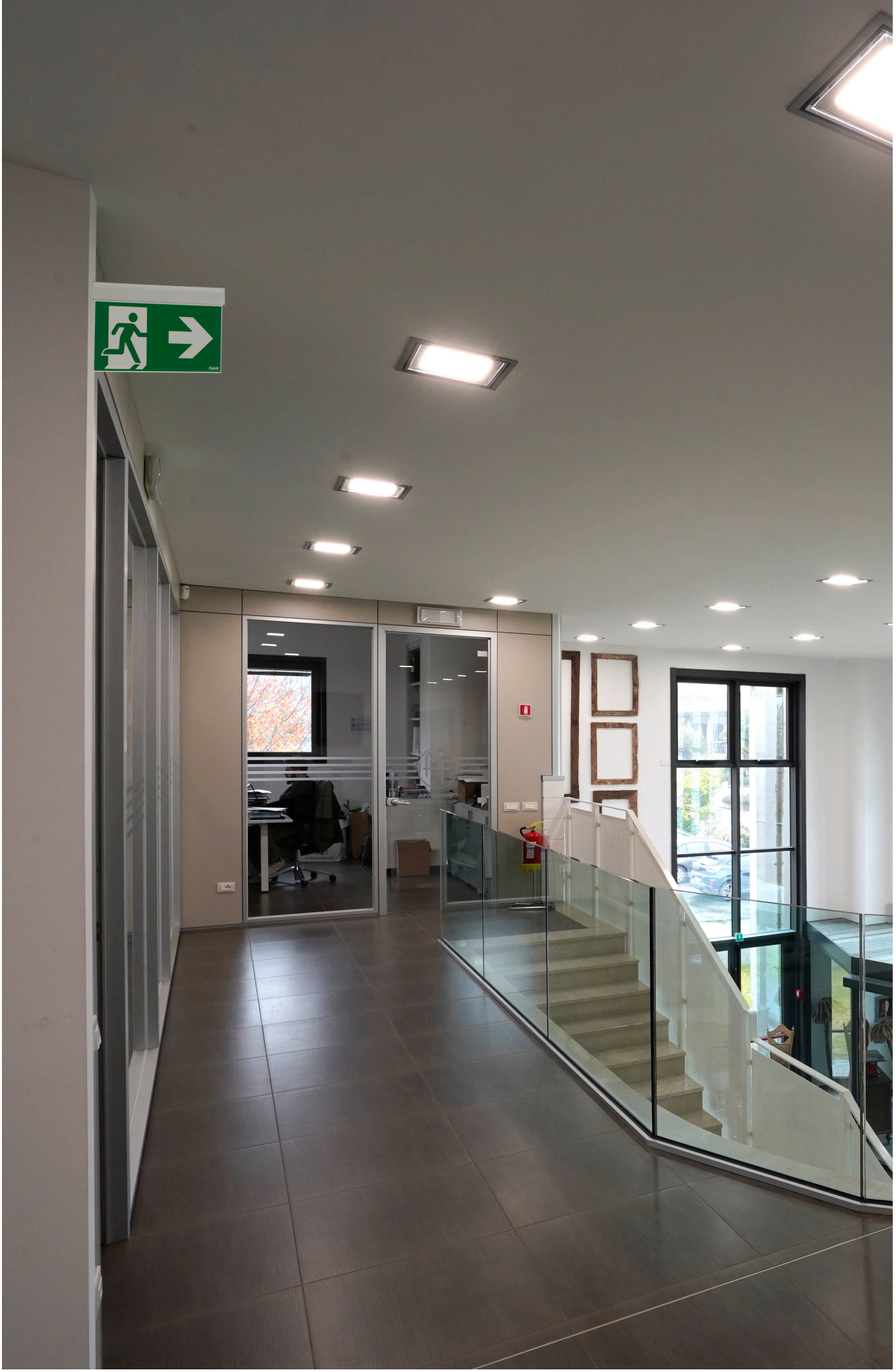
135 segnaletica / exit sign
