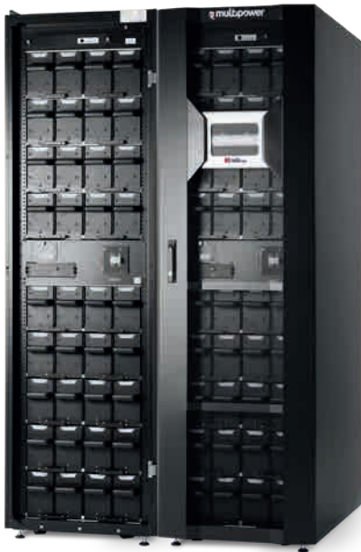
Battery Cabinet (MPW 170 BTC) con porta aperta e chiusa.
