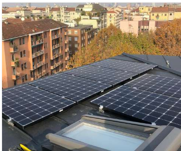
Tetto con lamiera aggraffata: fissaggio mediante staffe FVT1299 e profilo semplice in alluminio.
