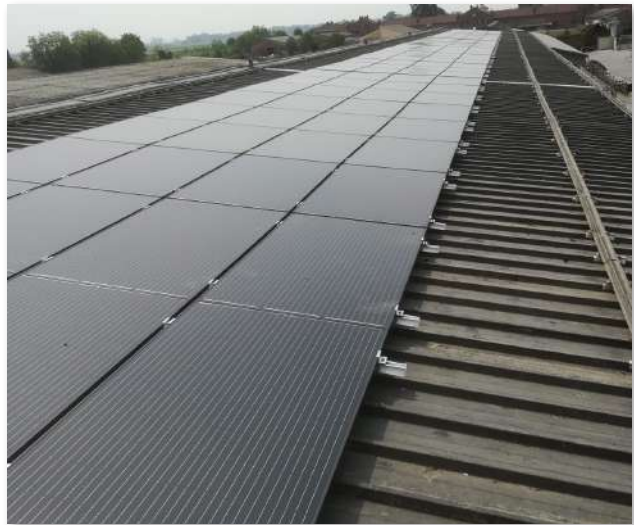
Tetto in lamiera grecata. Pannelli in orizzontale collegati sul lato lungo, supportati da spezzoni di profilo ribassato.
