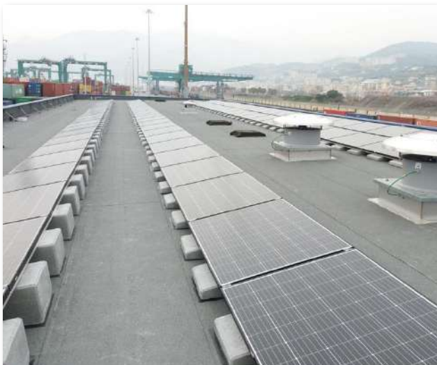
Tetto piano zavorrato con pannelli in orizzontale inclinati a 10°.
