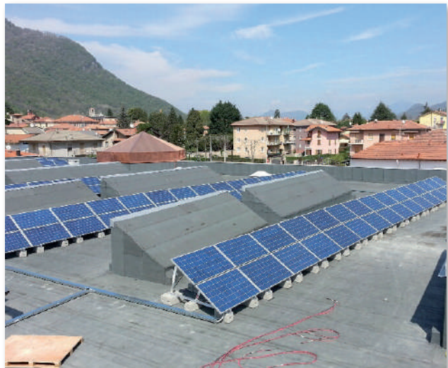
Impianto su tetto piano realizzato con triangolo doppio orizzontale a 30° e zavorre.
