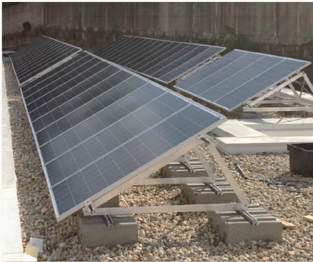
Impianto su tetto piano con ghiaia realizzato con triangolo singolo verticale a 30° zavorrato.
