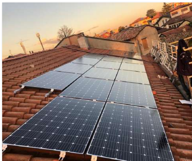
Tetto a falda con tegole. Fissaggio con staffe e pannelli in orizzontale collegati sul lato corto.
