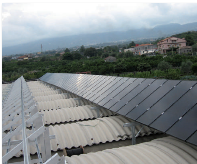
Installazione su tetto a cupolotti su triangoli.
