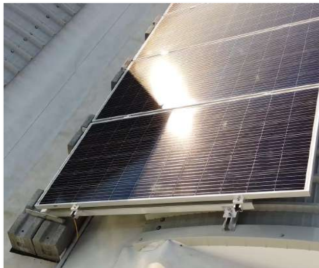
Installazione mista su tetto piano e cupolini
