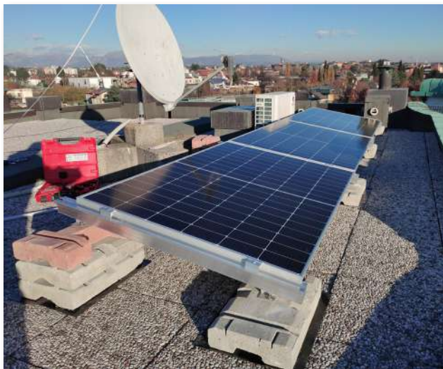
Impianto su tetto piano realizzato con zavorre MTT. Modulazione del peso necessario per inclinazione di 10°.
