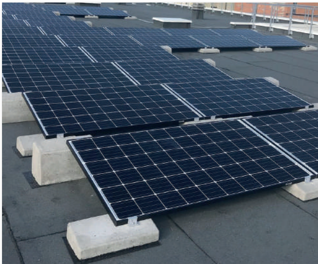
Tetto piano zavorrato con pannelli in orizzontale inclinati di 10° fissati sul lato lungo.
