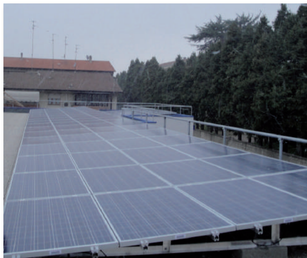
Impianto a vela realizzato su tetto piano con triangolo quadruplo orizzontale e zavorrato.
