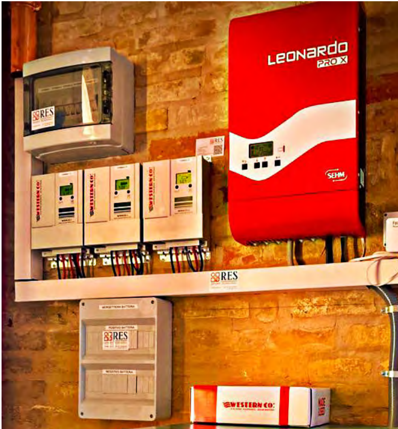
Leonardo PROX - 5000 DC Pylontech San Benedetto del Tronto - Italy
