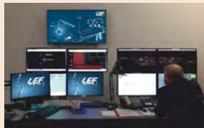
Sistema di supervisione SCADA Il sistema di controllo e monitoraggio LEF all'interno di una sala movimento che controlla gli Armadi di Piazzale (ADP) e l'illuminazione
