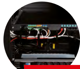
Prese di alimentazione sull'UPS
